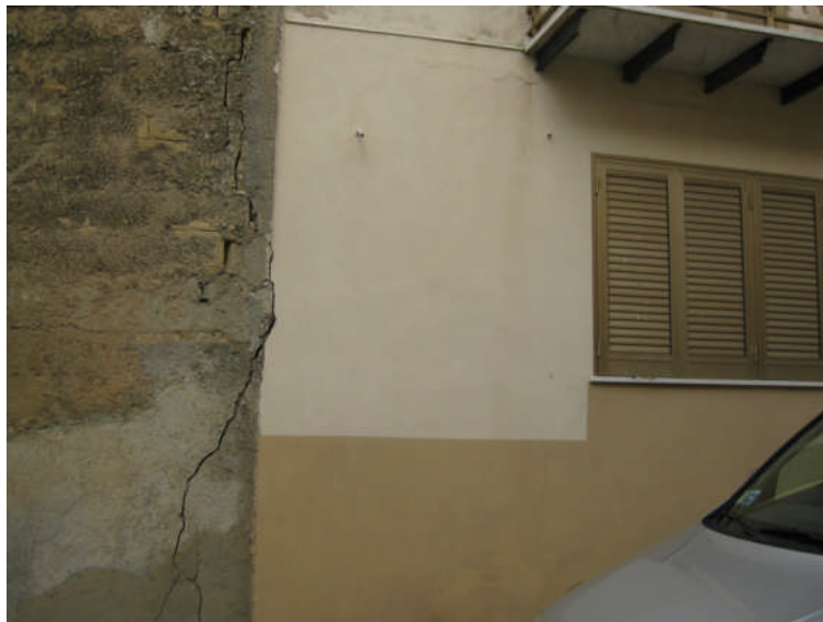
Lesione sub verticale di media entità interessante un fabbricato in muratura
