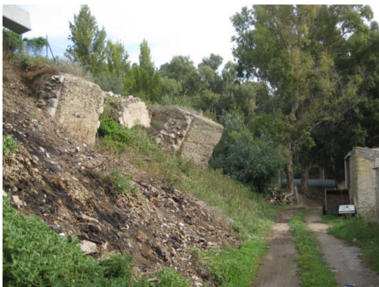
Muro in calcestruzzo ciclopico a valle di via Ospizio scivolato e ribaltato
