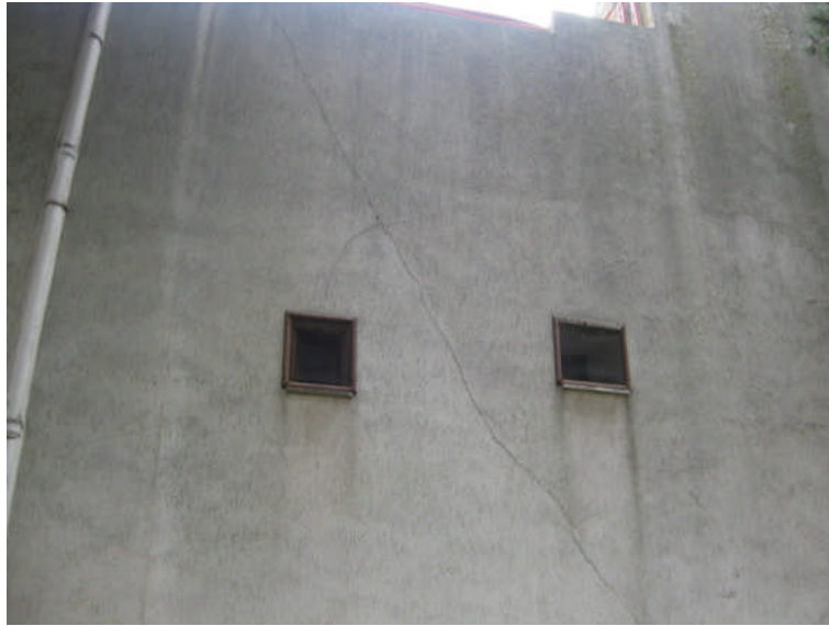
Lesione passante in corrispondenza di un muro portante di un fabbricato
