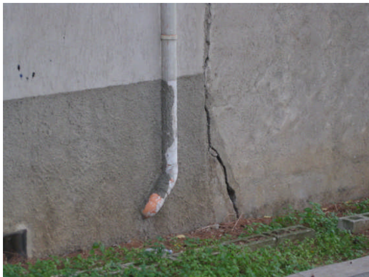
Ampia lesione presente in corrispondenza della base di un edificio del c.a.
