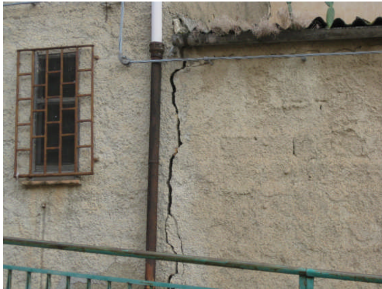
Lesione verticale passante molto ampia che interessa due fabbricati contigui
