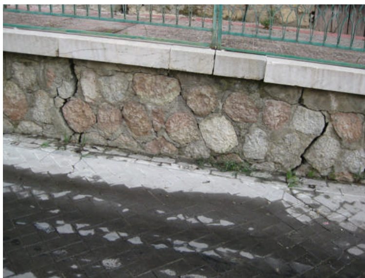
Lesioni del muretto-marciapiede e avvallamento della sede stradale urbana
