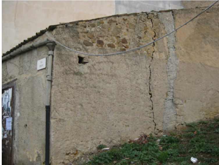
Lesione passante subverticale attraversante l'intera parete di un fabbricato
